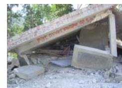
Le bâtiment après le séisme
